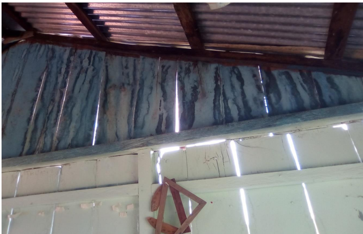
Filtración de agua por el interior de las paredes de los salones de clase.
