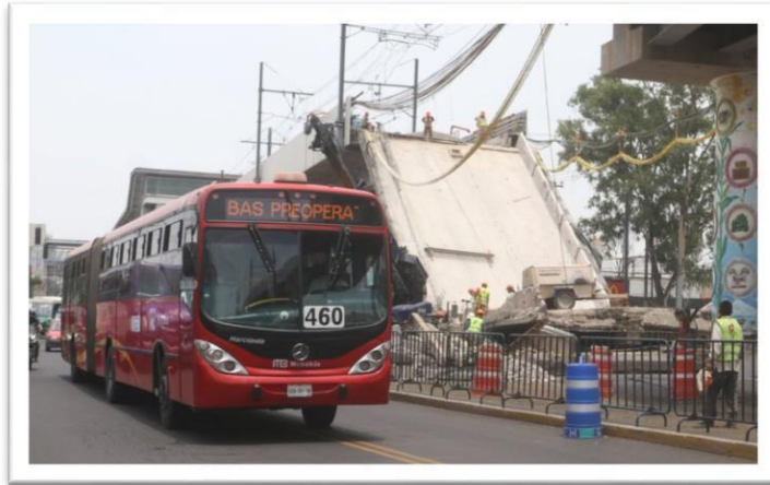
Imagen #5. Caída de la línea 12 Iztapalapa, Fuente. Internet
