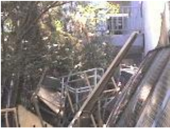
Antes de darle mantenimiento
